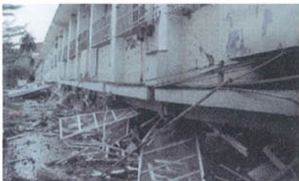
▲南投永昌國小於 921 地震受損嚴重
